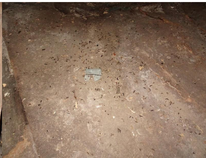
Fot. 3. Strych kościoła w Żarach Wielkich z odchodami kolonii rozrodzej gacka brunatnego/gacka szarego (fot. A. Koczan)
